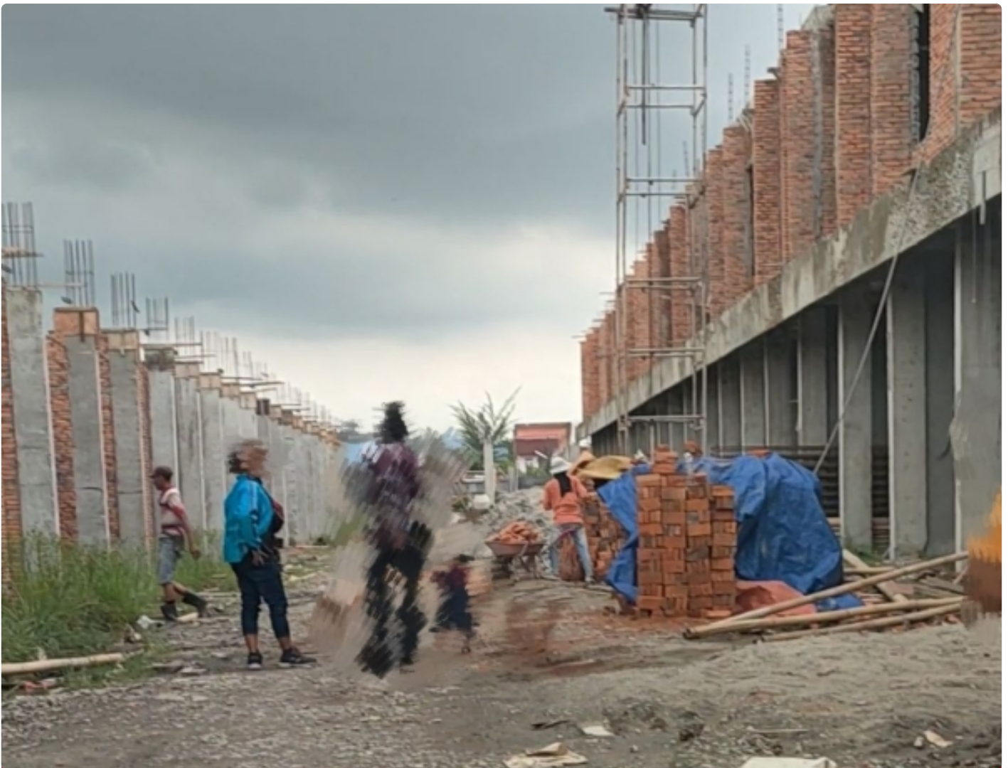
Bangunan di Jalan Air Bersih Ujung yang diduga menyalahi SIMB
